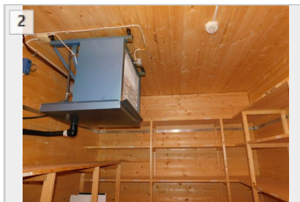
Kjøle- og fryserom i enden mot nord
