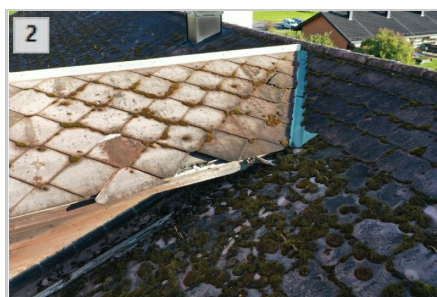
Mye mose, og slitasje på taket
