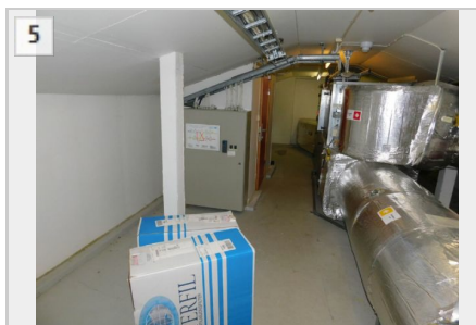
Ventilasjon på kaldloft
